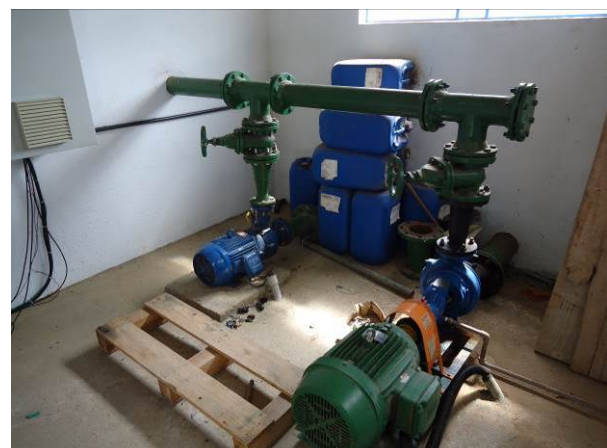
Figura 101. Vista dos conjuntos motor-bombas
