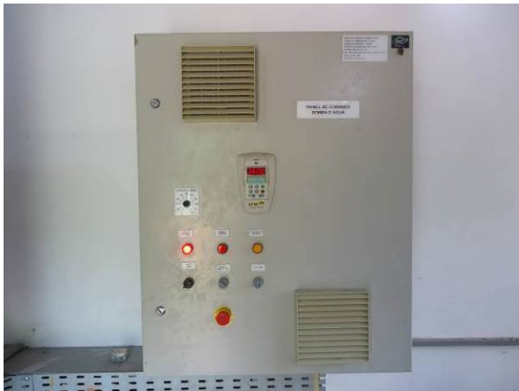
Figura 61. Vista do painel elétrico fechado
