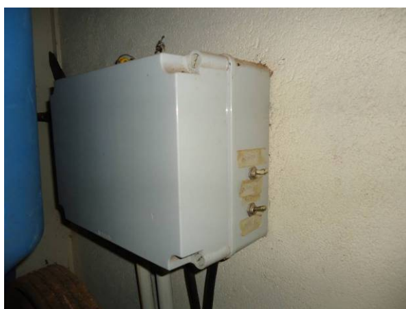
Figura 122. Vista do painel elétrico do booster do Parque dos Ipês.
