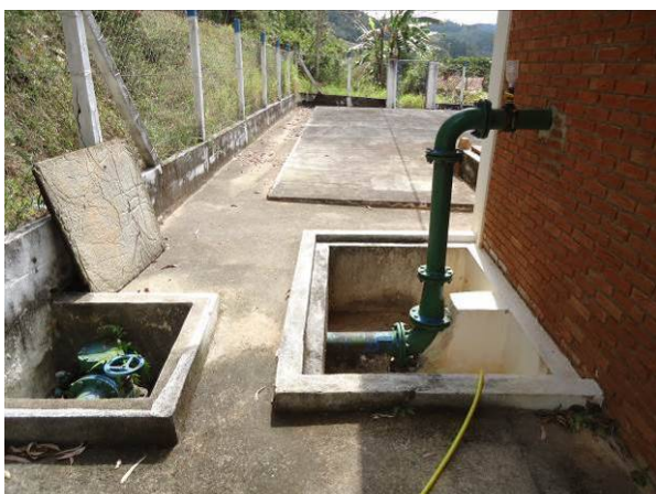
Figura 100. Tubulação de saída da casa de Bombas
