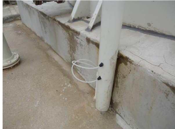
Figura 159. Vista das tubulações de aplicação de químicos
