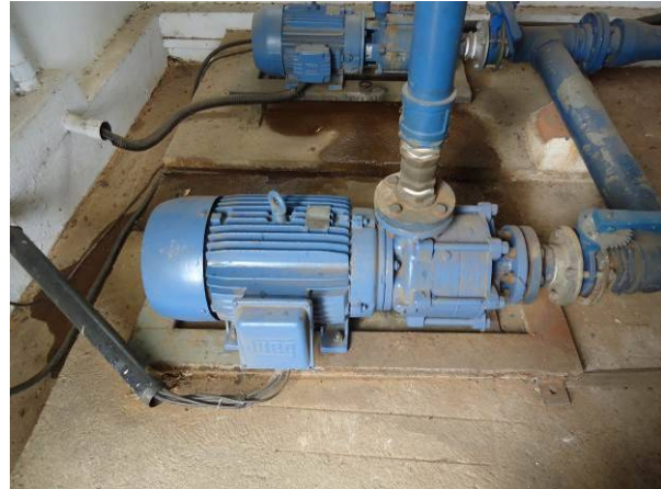
Figura 141. Vista detalhada do conjunto motor-bomba operante
