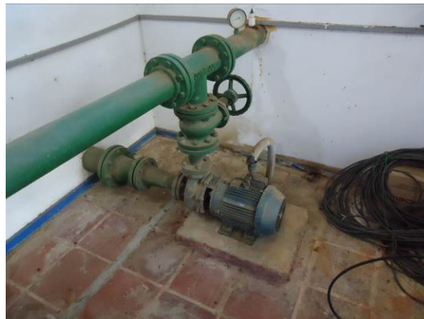
Figura 93. Vista do conjunto moto bomba reserva
