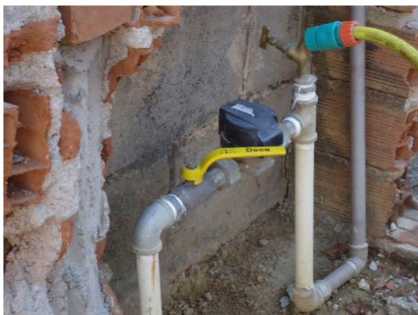
Figura 165. Vista do Hidrômetro sem lacre na Rua Joaquim De Oliveira Nº 136 - Centro
