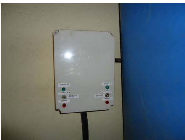
Figura 178. Painel elétrico da Estação Elevatória de Esgoto (EEE) existente no Parque dos Ipês
