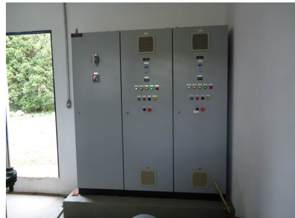
Figura 84. Vista do Painel elétrico dos conjuntos moto-bomba
