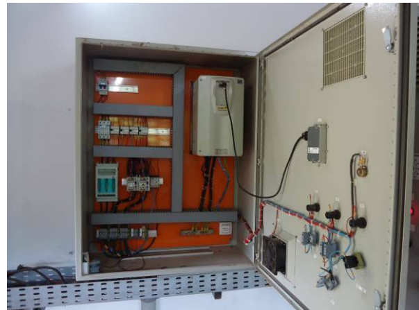
Figura 91. Vista do Painel elétrico aberto dos conjuntos moto-bomba
