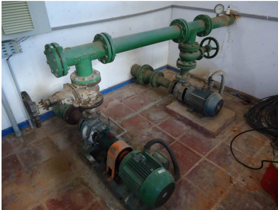
Figura 89. Elevatória com dois (02) conjuntos moto-bomba
