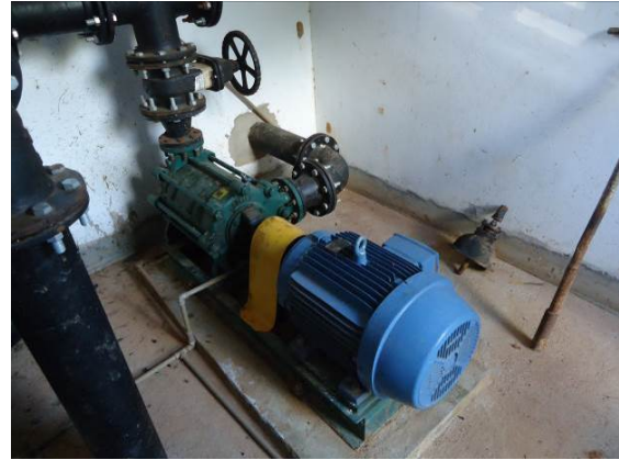
Figura 86. Vista do conjuntos moto-bomba
