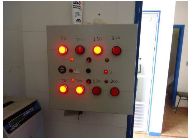
Figura 82. Vista do medidor de nível
