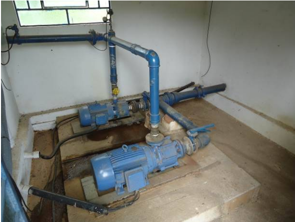
Figura 140. Vista dos conjuntos motor-bombas
