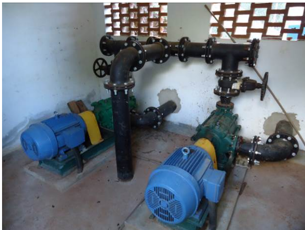
Figura 83. Elevatória com dois (02) conjuntos moto-bomba
