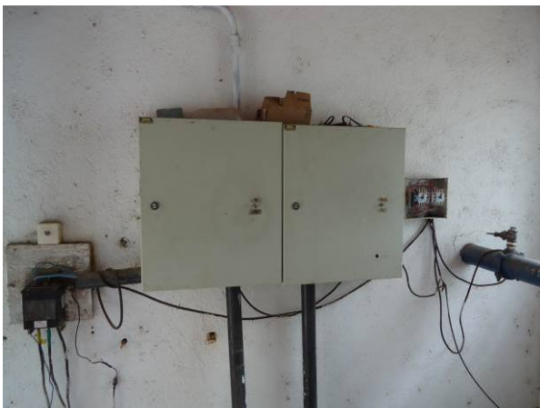
Figura 149. Vista do painel elétrico de Comando de Bomba
