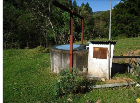
Figura 60. Vista do poço de sucção com bombas submersas e painel primário
