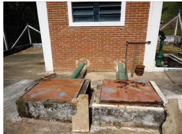
Figura 99. Vista das tubulações de sucção da casa de bombas
