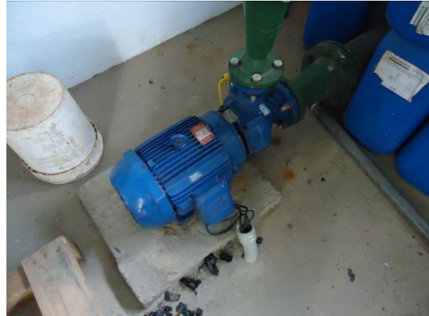
Figura 103. Vista do conjunto motor-bomba reserva
