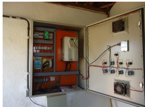
Figura 128. Painel Elétrico de Comando de Bomba
