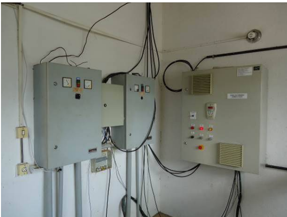
Figura 104. Vista do painel elétrico
