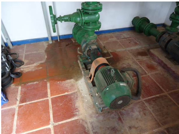
Figura 92. Vista do conjunto moto bomba operante
