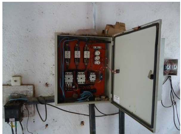
Figura 150 Vista do painel elétrico aberto de Comando de Bomba
