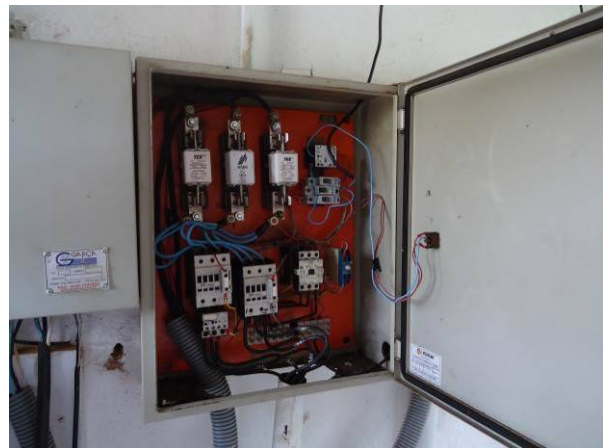
Figura 143. Vista do painel elétrico de Comando de Bomba aberto
