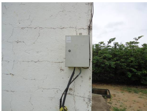
Figura 154. Vista do painel elétrico de Comando de Bomba
