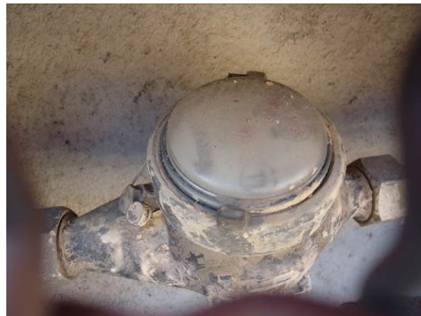
Figura 170. Vista do Hidrômetro com visor embaçado na Rua Joaquim De Oliveira Nº 54 - Centro
