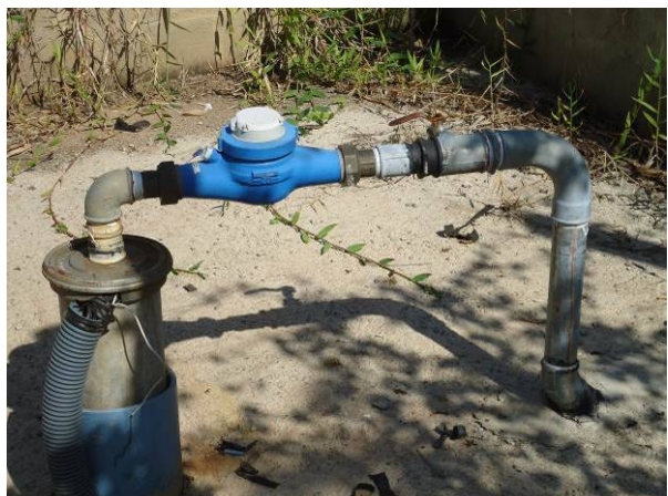
Figura 163. Vista do poço tubular profundo
