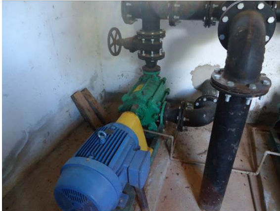
Figura 85. Vista do conjuntos moto-bomba 1
