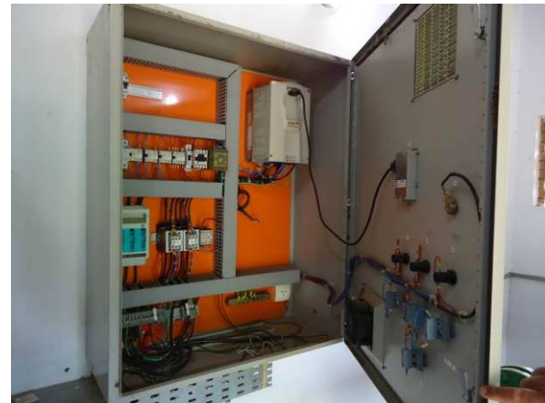
Figura 62. Vista do painel elétrico aberto
