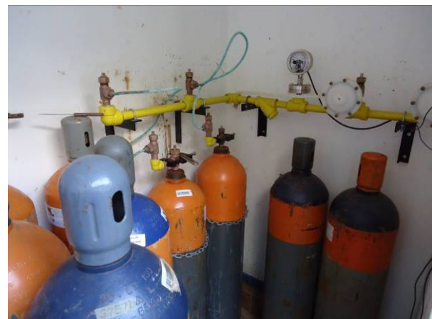
Figura 76. Vista dos botijões de armazenamento do cloro gás.
