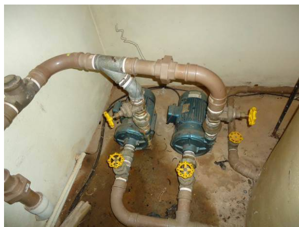
Figura 121. Vista dos conjuntos motobomba do “booster”
