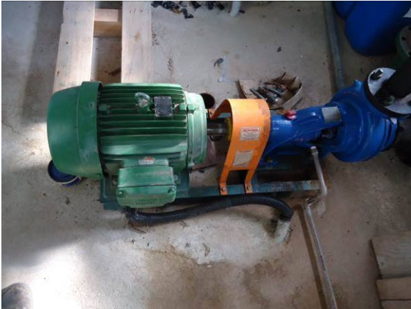
Figura 102. Vista detalhada do conjunto motor-bomba
