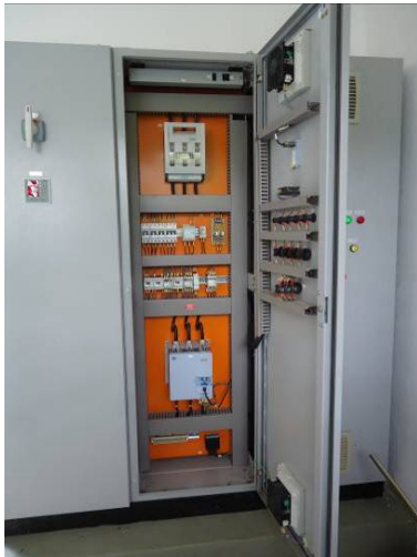
Figura 87. Vista do Painel elétrico aberto dos conjuntos moto-bomba
