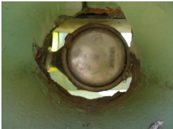
Figura 169. Vista do Hidrômetro com visor embaçado na Rua Joaquim De Oliveira Nº 270 - Centro
