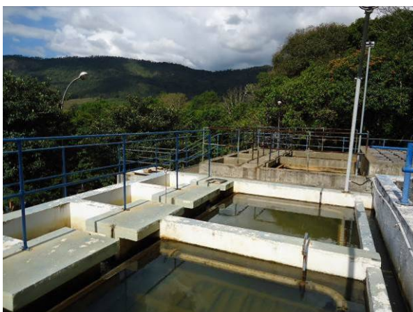
Figura 68. Vista geral dos decantadores
