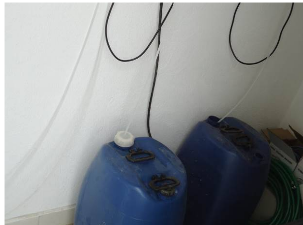
Figura 161. Vista dos galões de armazenamento de químicos
