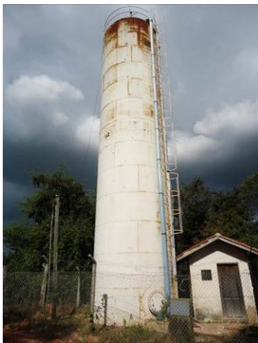
Figura 112. Vista frontal do Reservatório Ponte Preta
