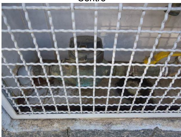
Figura 167. Vista do Hidrômetro sem lacre na Rua Joaquim De Oliveira Nº 78 - Centro
