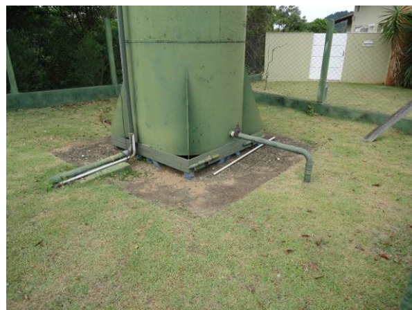
Figura 119. Tubulações de saída e de entrada do reservatório
