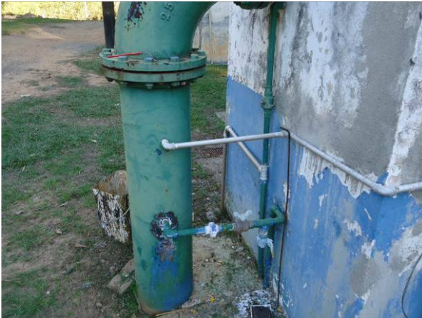
Figura 73. Aplicação de cloro na saída da linha 1
