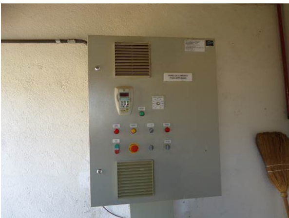
Figura 127. Painel Elétrico de Comando de Bomba
