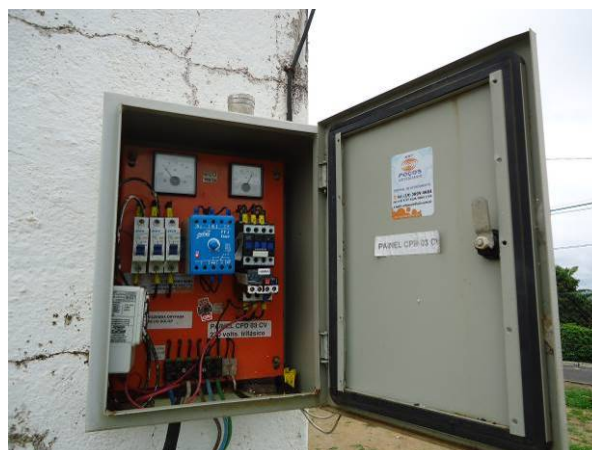
Figura 155. Vista do painel elétrico de Comando de Bomba aberto
