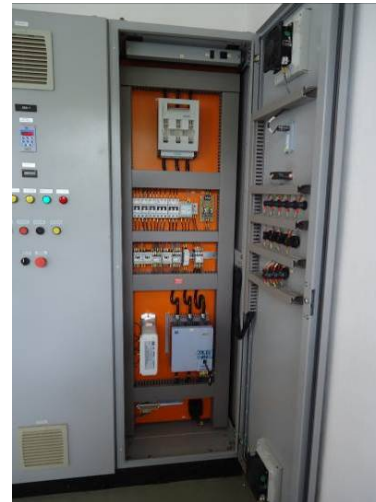
Figura 88. Vista do Painel elétrico aberto dos conjuntos moto-bomba
