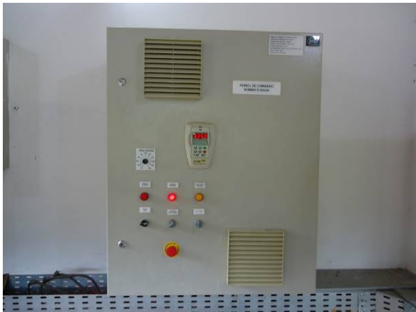
Figura 90. Vista do Painel elétrico dos conjuntos moto-bomba
