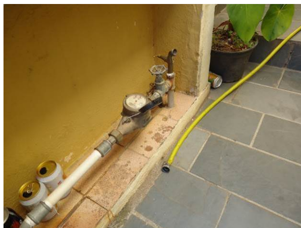
Figura 166. Vista do Hidrômetro sem lacre na Rua Joaquim De Oliveira Nº 60 - Centro
