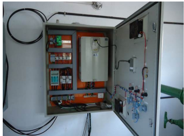
Figura 105. Vista do painel elétrico aberto
