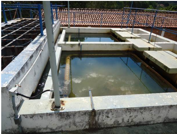
Figura 66. Vista do decantador da Linha1
