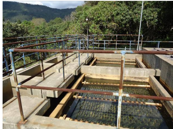
Figura 67. Vista do decantador da Linha2
