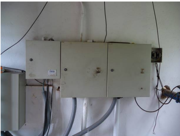
Figura 142. Vista do painel elétrico de Comando de Bomba
