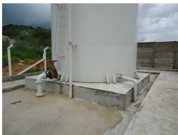
Figura 157. Vista das tubulações de saída do Reservatório
