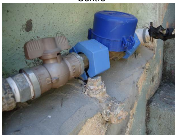
Figura 168. Vista de Hidrômetro com lacre rompido na Rua Joaquim De Oliveira Nº 284 - Centro
