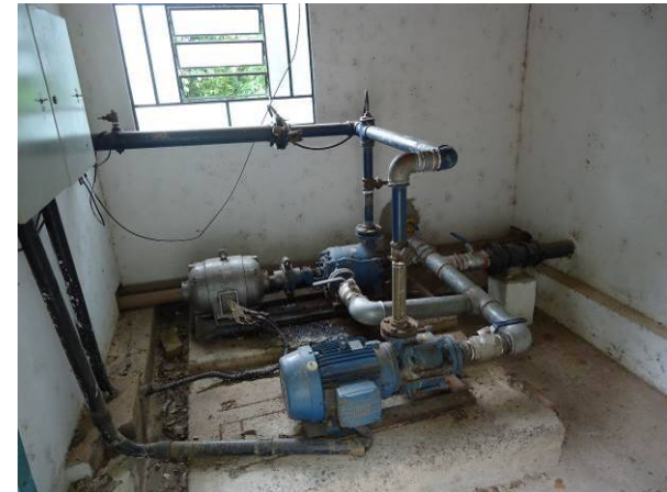
Figura 148 Vista dos conjuntos motor-bombas
