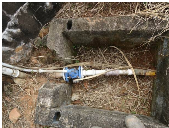
Figura 117. Válvula de altitude instalada na entrada do reservatório
